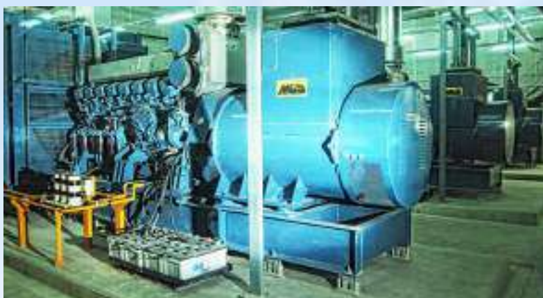
TEMPO SCAN TOWER - 3 x 2030 KVA
