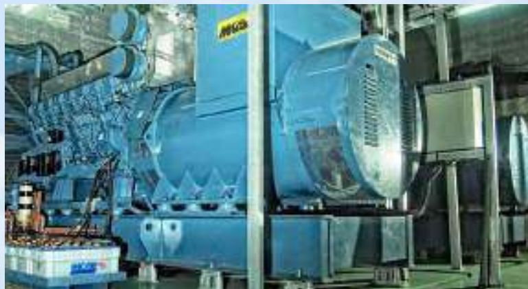
EMPORIUM PLUIT MALL - 2 x 2030 KVA
