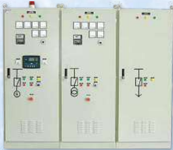
Panel AM/ATS Kapasitas 1000 KVA
