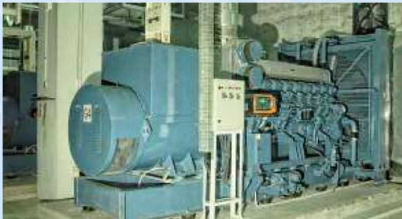
TANGERANG CITY - 1 x 375 KVA + 4 x 2030 KVA
